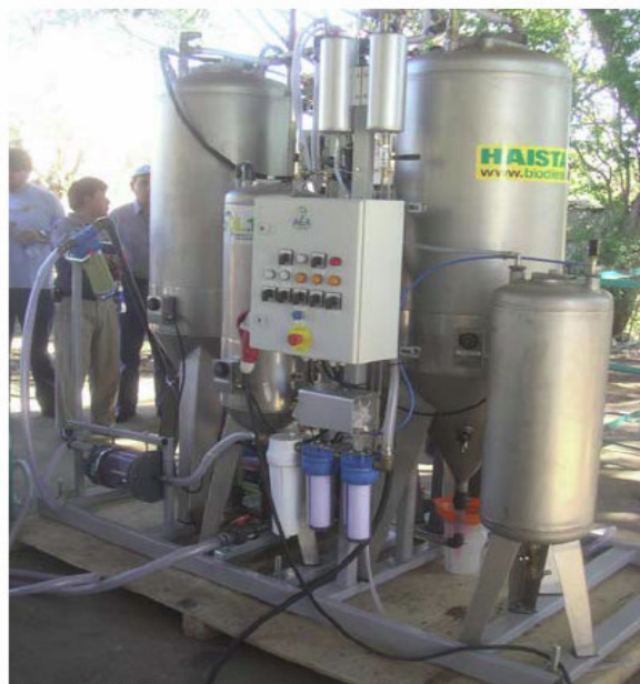
Fig. 1.2 Vista de la Planta Piloto
